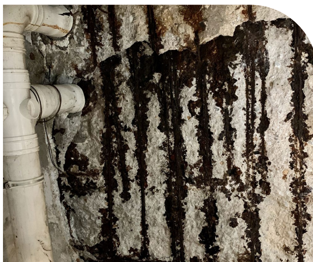
屋內牆身老化造成危險
